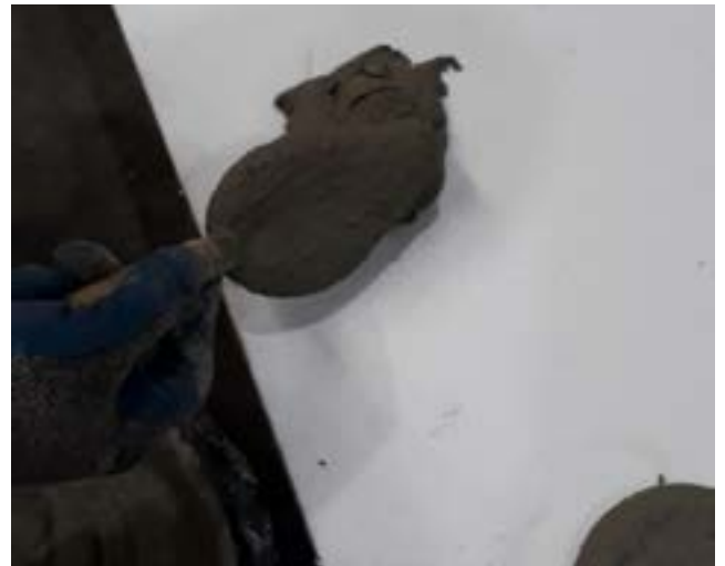
Colocar el adhesivo en la cara del aislante en forma de motas y con ayuda de una cuchara de albañil
